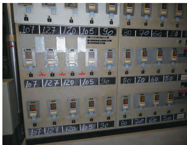
乾燥機制御盤
